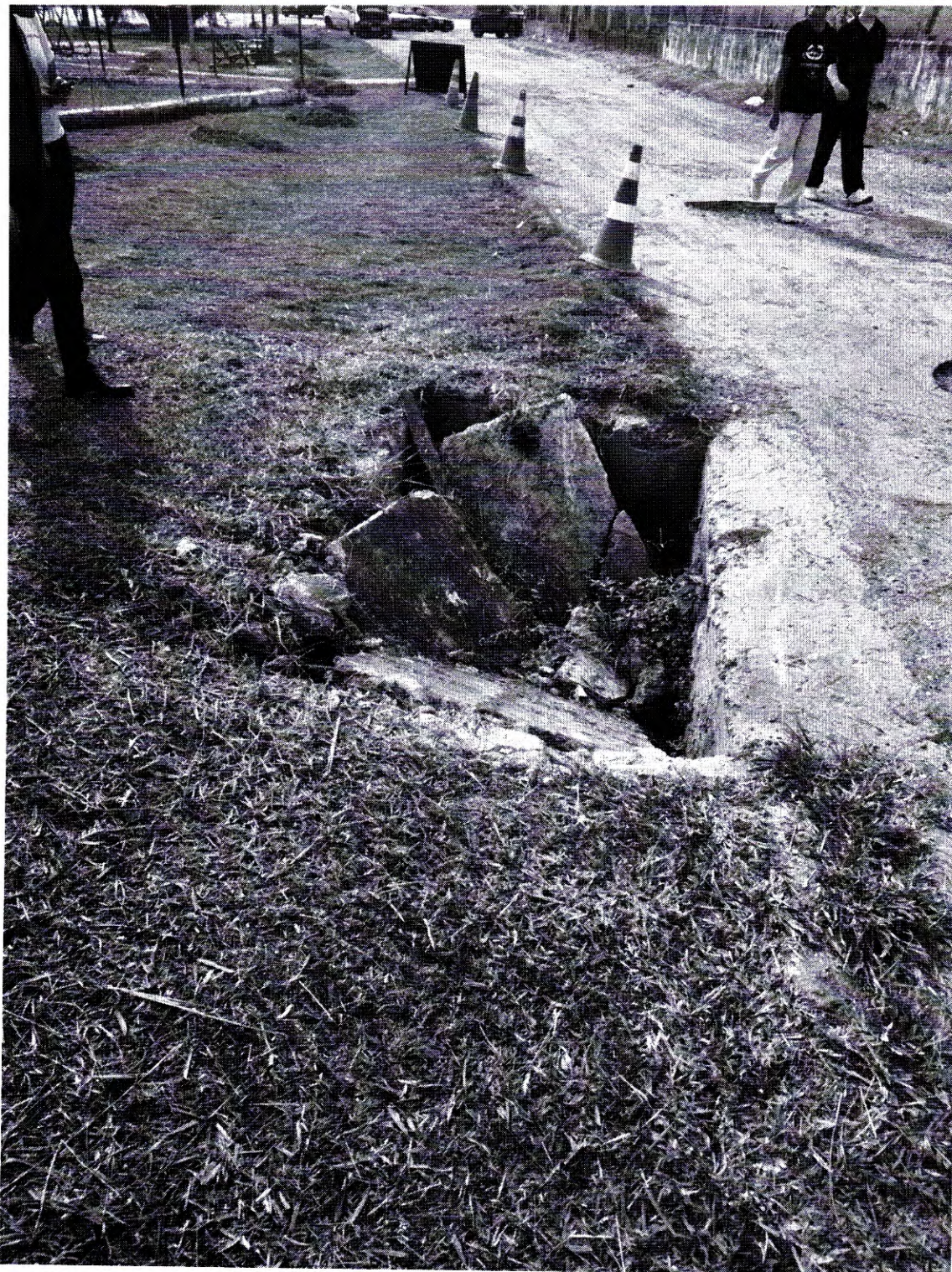
Bueiro exposto na Área de Lazer 2
