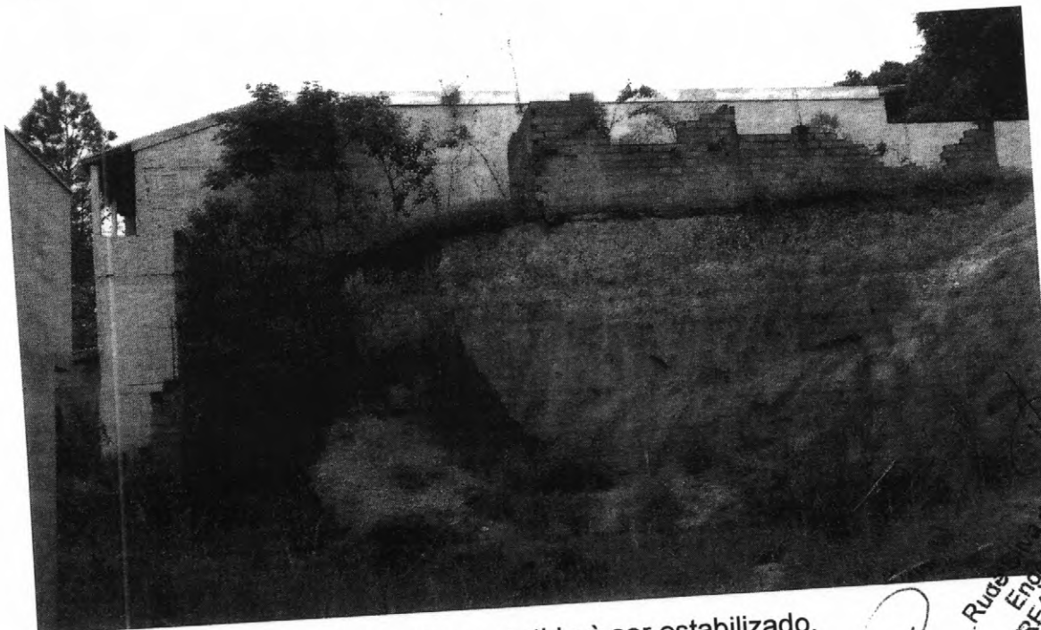
Foto nº: 03- Vista do talude comprometido à ser estabilizado.
