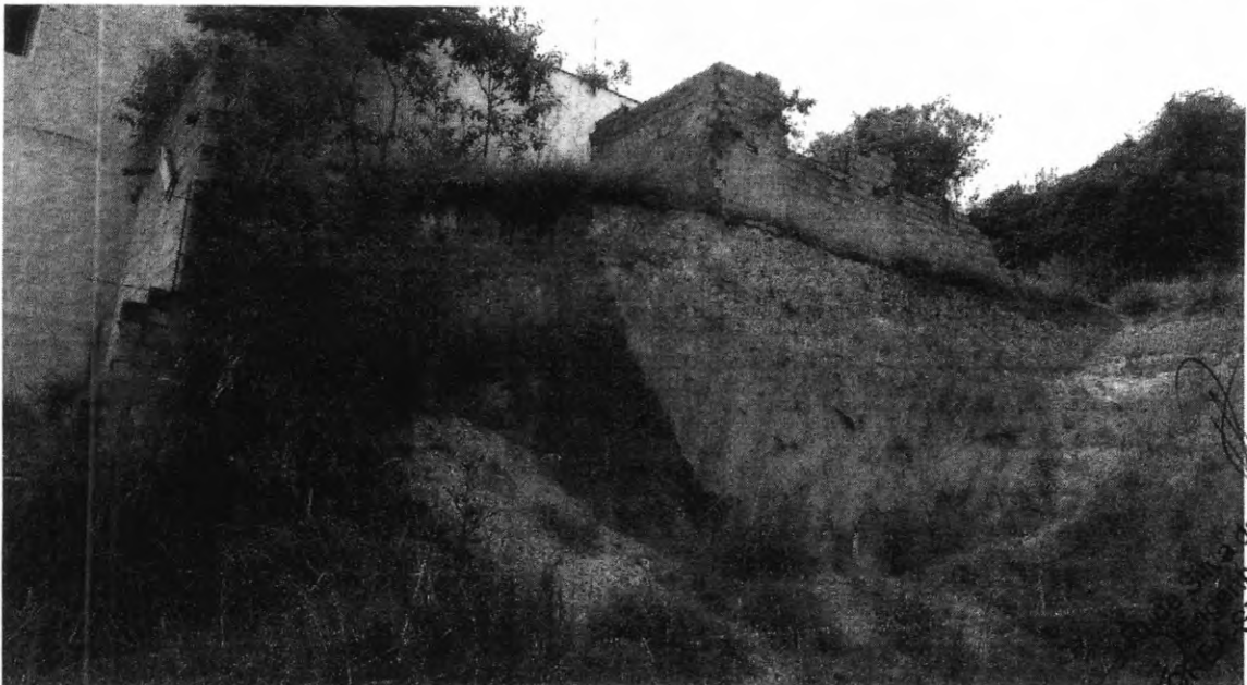
Foto nº: 02- Vista do talude comprometido à ser estabilizado.
