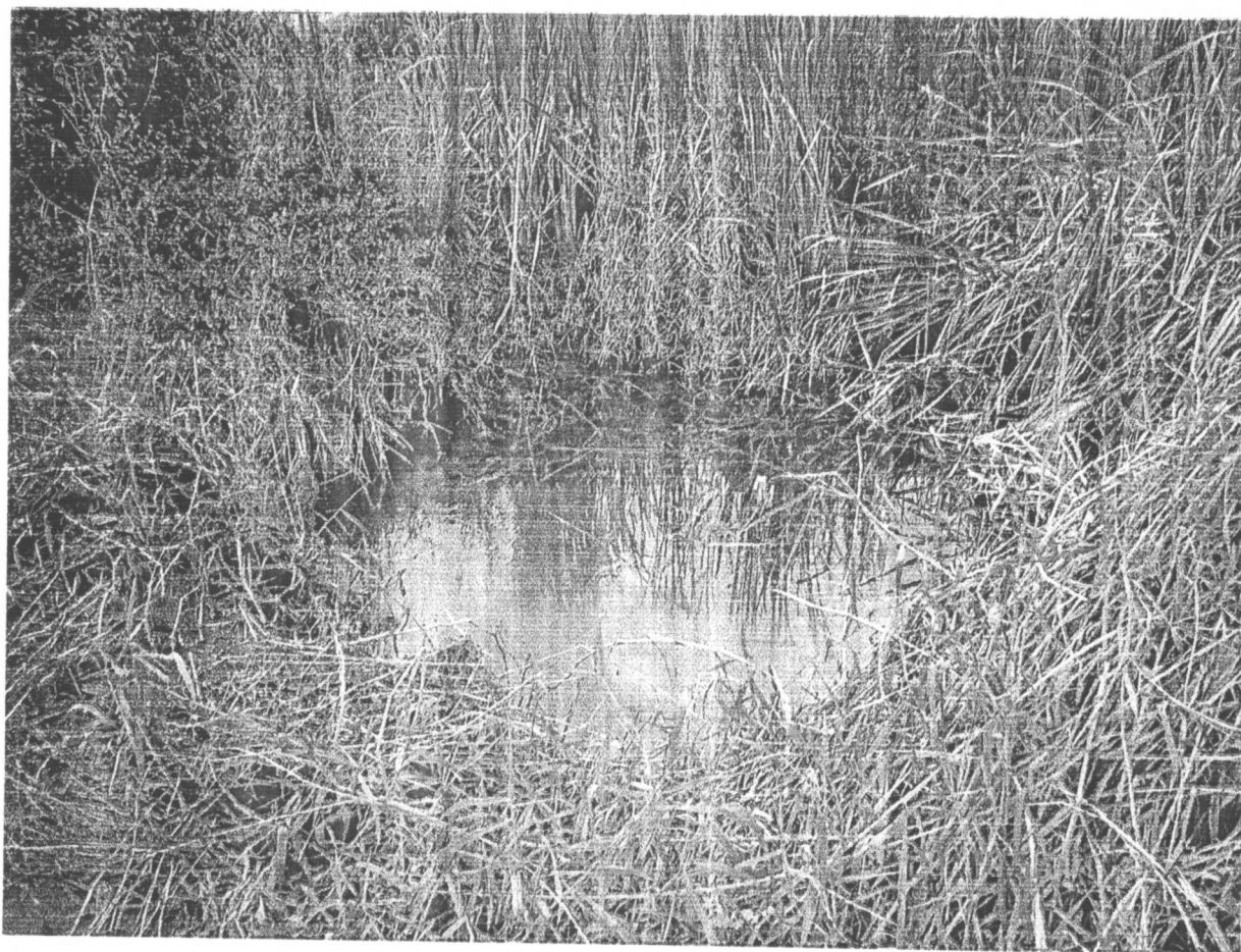
Estrada Irmãos Maeda – Córrego entupido, necessita de limpeza.
