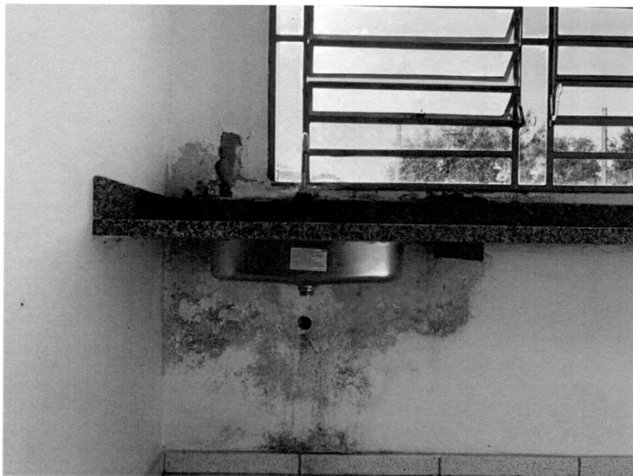
Foto 34 - Infiltrações existentes, ausência de sifão
