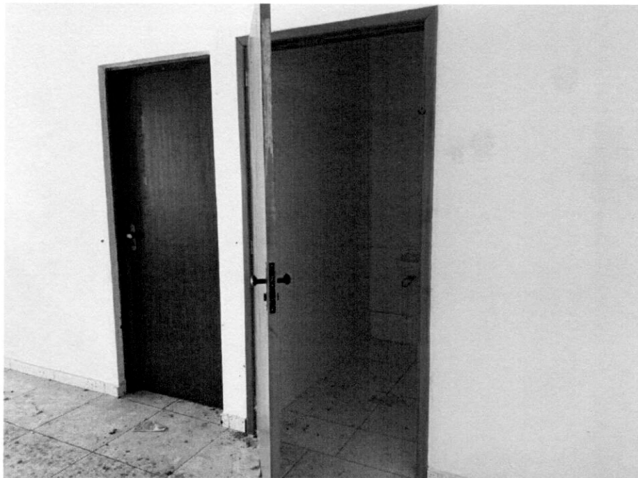
Foto 12 - Ausência de barras de apoio conforme NRB-9050
