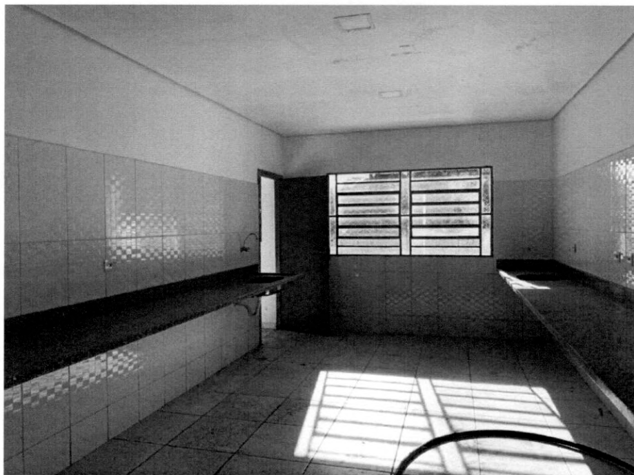
Foto 27 - ausência de torneira
