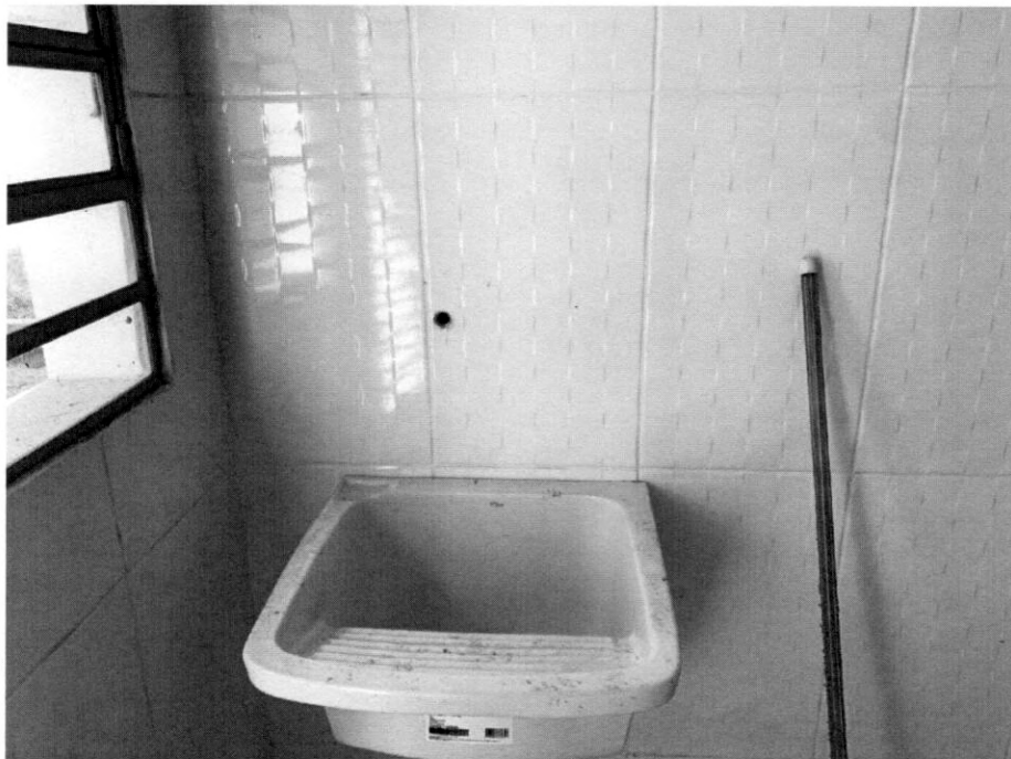
Foto 21 - Ausência de torneira
